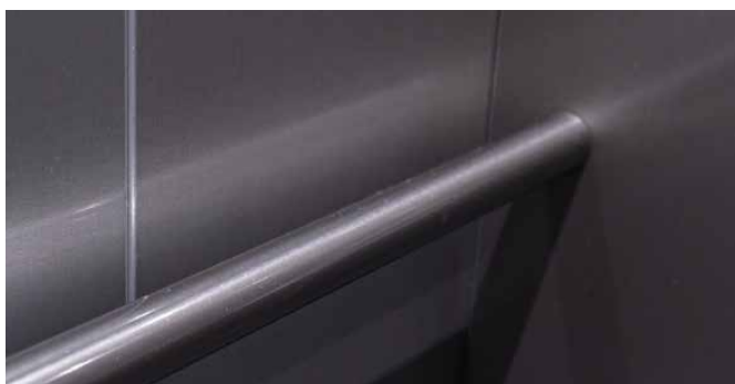
Handlaufbefestigung an den Stirnseiten (im Bild links über Eck)
